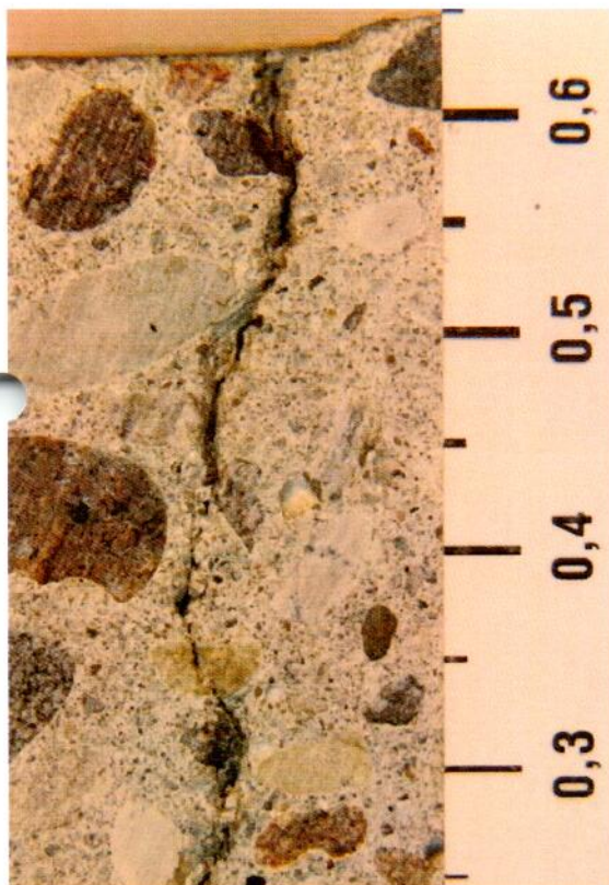
Fig. 2. Początek otwartej rysy
