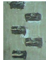
Fot. 1. Uszczelnienie Hydrostopem-Superelastycznym 2kg/m 2 styku powłoki penetrującej z metalowym osprzętem zbiornika przeciwpożarowego – widoczne klamry żelazne w ścianie pod włazem zbiornika.
