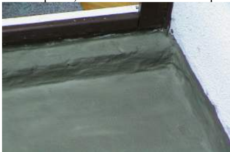
Fot. 1. Uszczelnienie Hydrostopem-Elastycznym 2,0kg/m 2 , cienkiej, podatnej na zarysowania włosowate zbrojonej wylewki tarasu ocieplanego. Wylewka ma grubość 5cm i jest zbrojona siatką Rabitza. Dodatkowo styki
